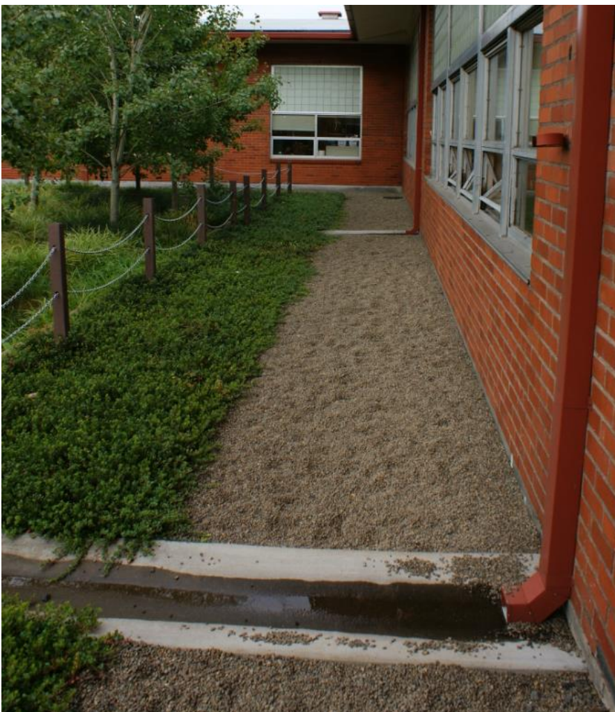
Figur 7-9 Exempel på avledning från hustak via stuprör och rännor.
