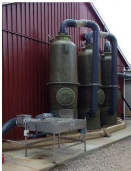
Figur 4-5. Oxidationsanläggning med järnoxid i tre steg (Centriair).
