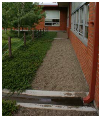
Figur 7. Exempel på avledning från hustak via stuprör och rännor. Sweco 2024
