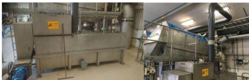
Figur 3-1 Externslammottagning med avluftning
