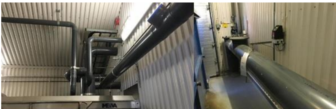
Figur 2. Ventilationskanalerna leds ihop till en samlingskanal.
