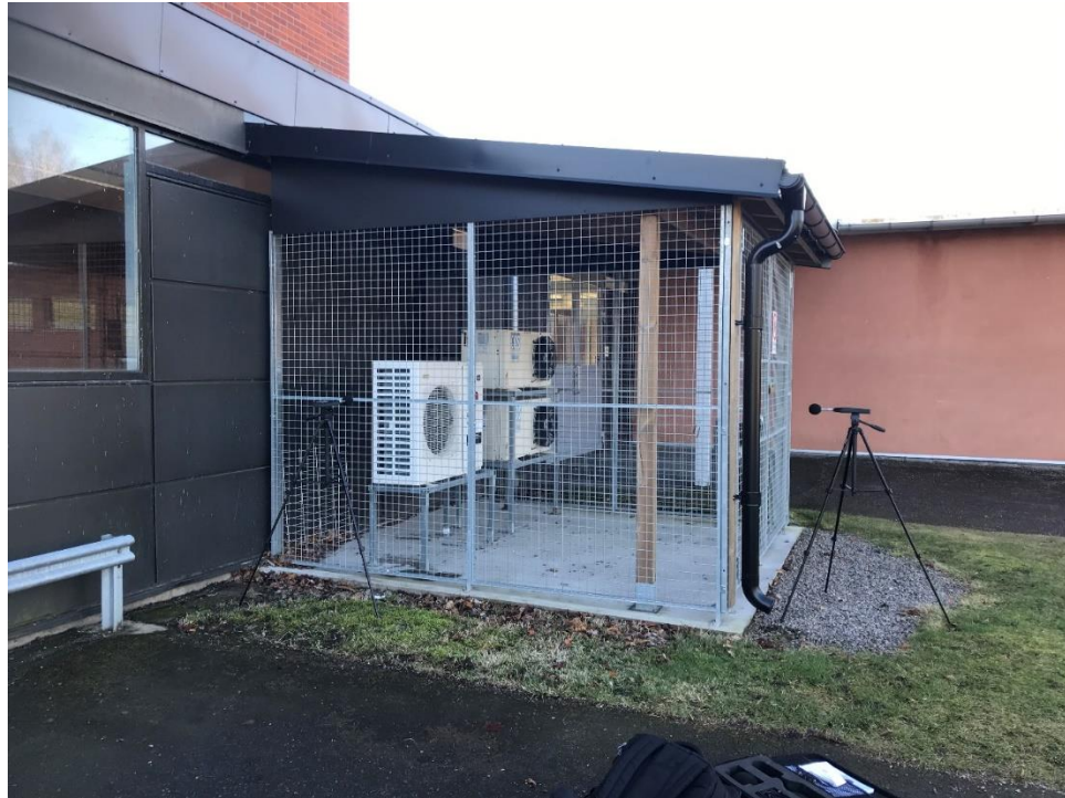
Figur 4 Två mätpositioner av fläkten/kompressor till kyl och fryssystemet på bårhuset
