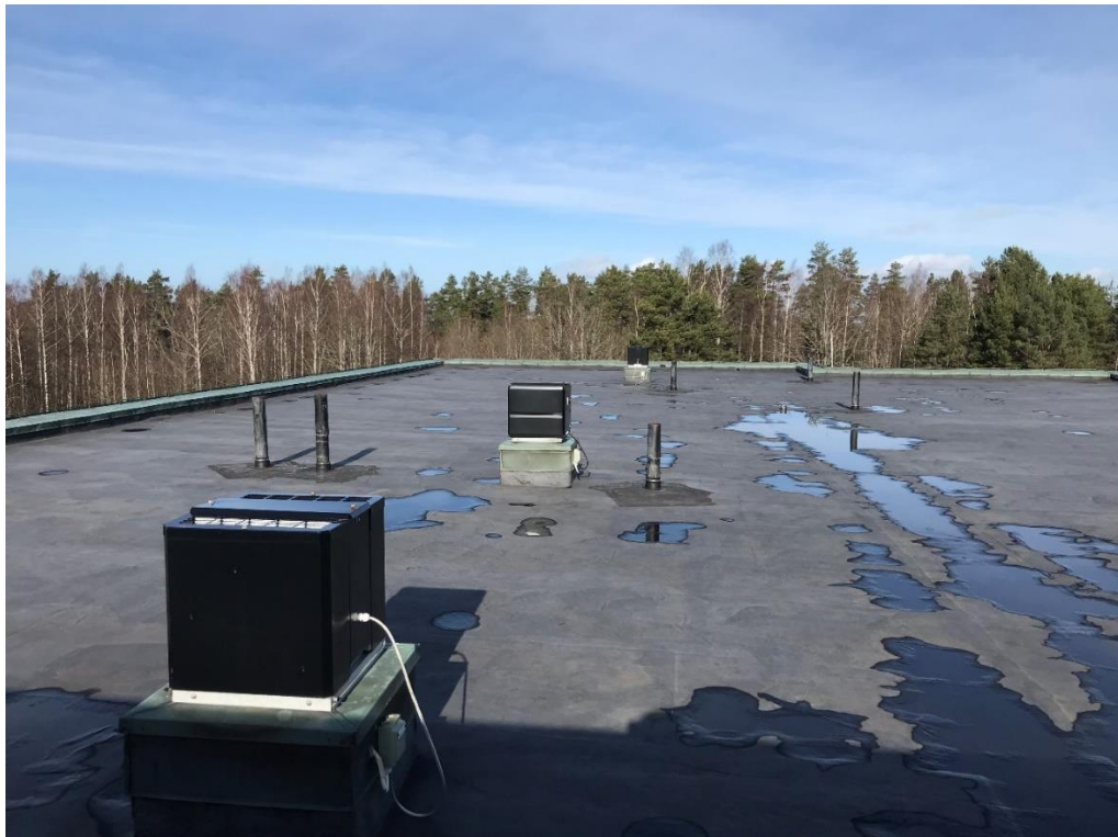
Mätplats 2: Frånluftshuvuden på taket från soprum mm, 3 st. Höjd över tak = 0,7 m
