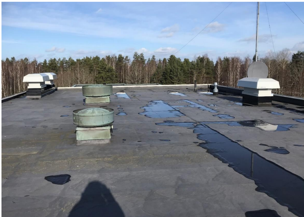
Mätplats 3: Tilluft på extrabyggnaden på taket (total antal = 4). Obs de runda mer i mitten används inte längre. Höjd över tak 0,5 m
