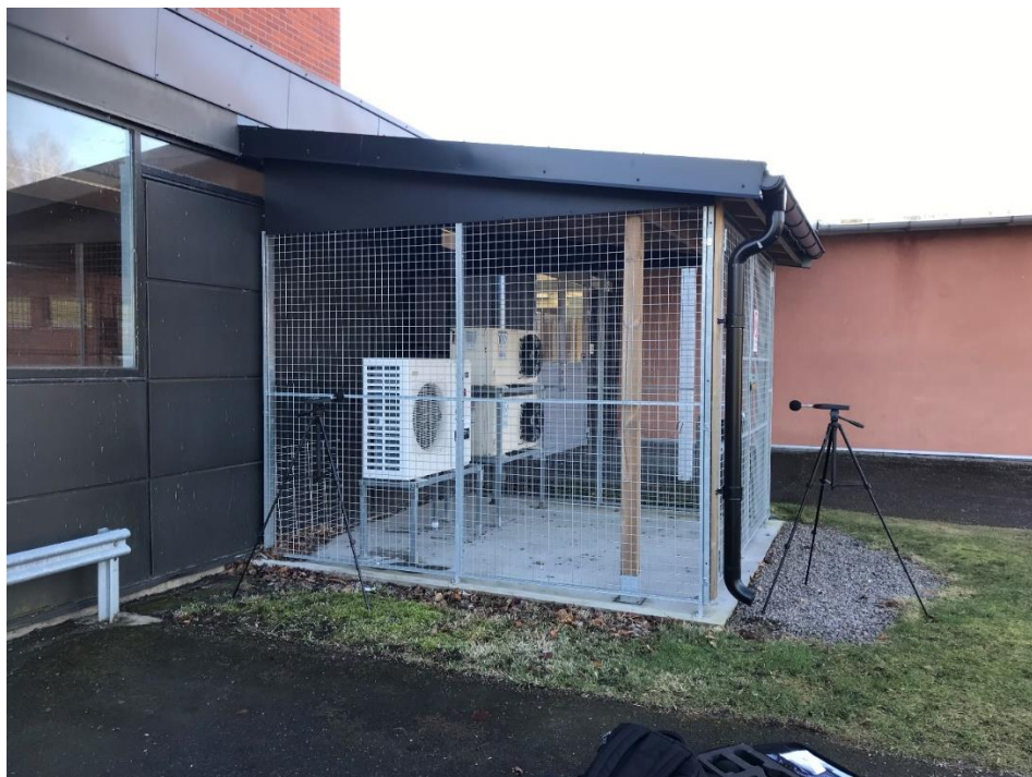
Mätplats 5: Fläkt till bårhuset (inburad) – låter då och då. När temperaturen på bårhuset sjunker kommer den igång en stund, sedan tystnar den. Höjd 1 m
